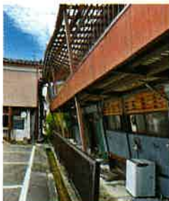
傾いて倒壊しそうな アパート
